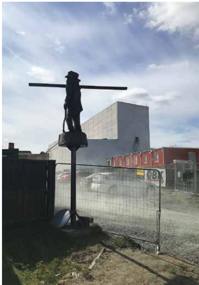
Bakom stabbläggaren av träskulptören Sven- Göran Niklasson reser sig det jättelika byggnadsverket, 135 meter långt.
