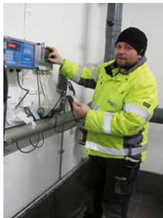
På Laxå vattenverk kontrollerar Samuel Schön att pH-mätaren visar rätt varje månad. Larm går ut till en beredskapstelefon om pH-värdet blir för högt eller lågt.
